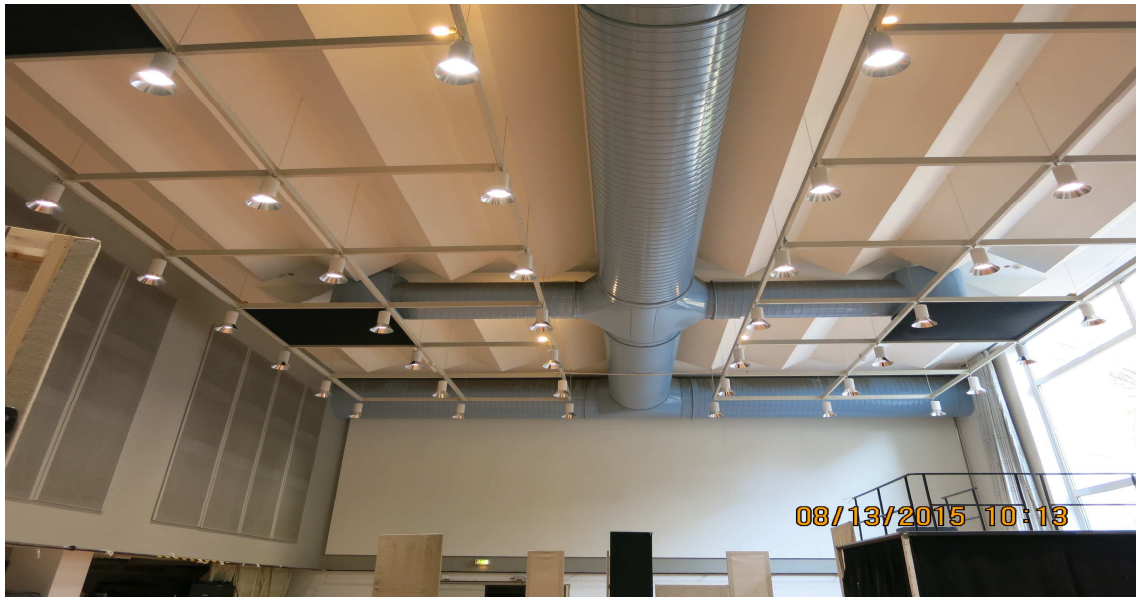
Bild 5: Beleuchtung Proberaum Orchester nach der Sanierung
