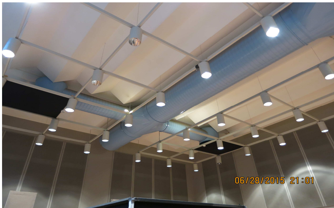
Bild 4: alte Beleuchtung „Proberaum Orchester“ (Stadttheater Münster)
