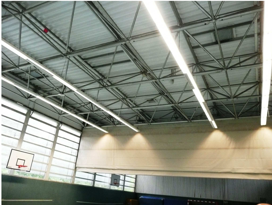
Bild2: alte Hallenbeleuchtung (Paulinum)
