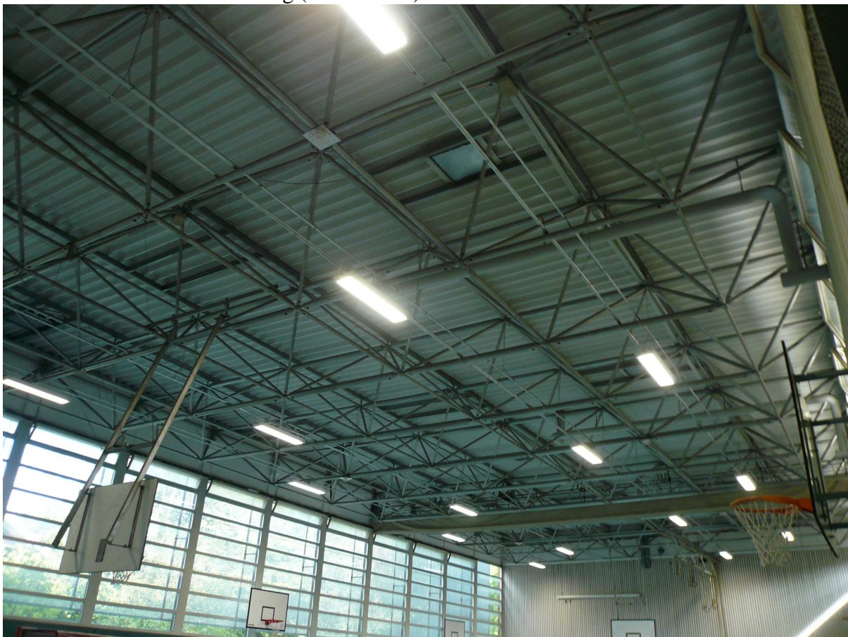
Bild 6: Neue Hallenbeleuchtung (Paulinum)
