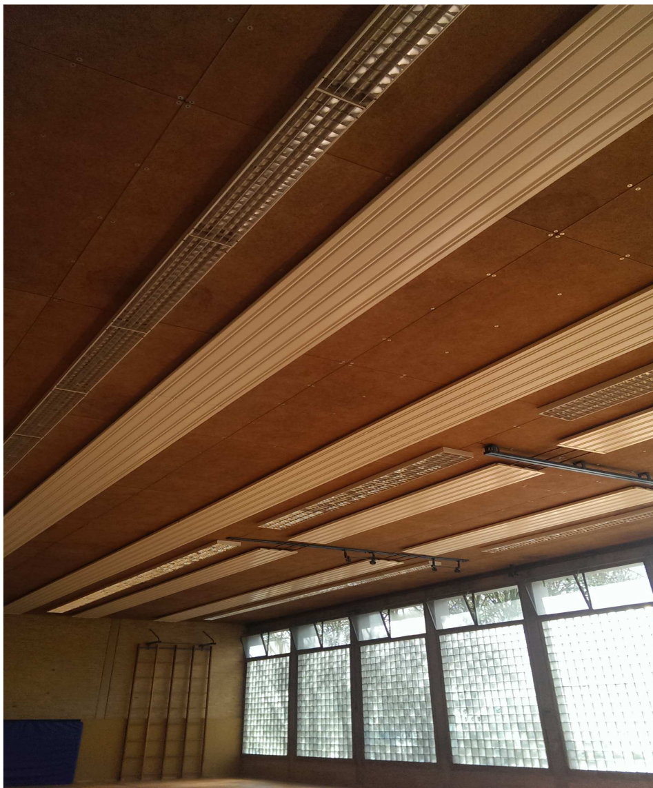
Bild1: alte Hallenbeleuchtung (Waldschule)
