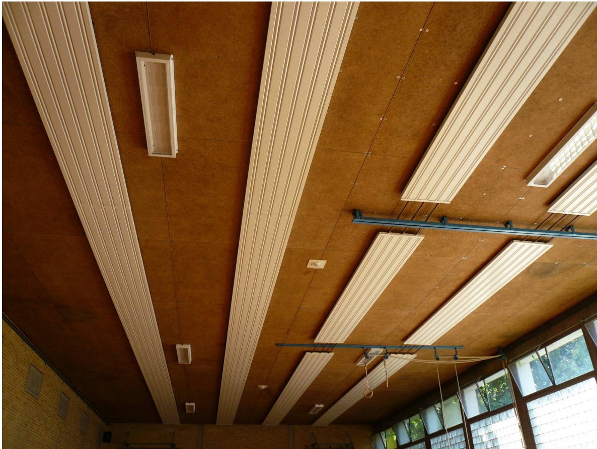
Bild 5: Neue Hallenbeleuchtung (Waldschule)
