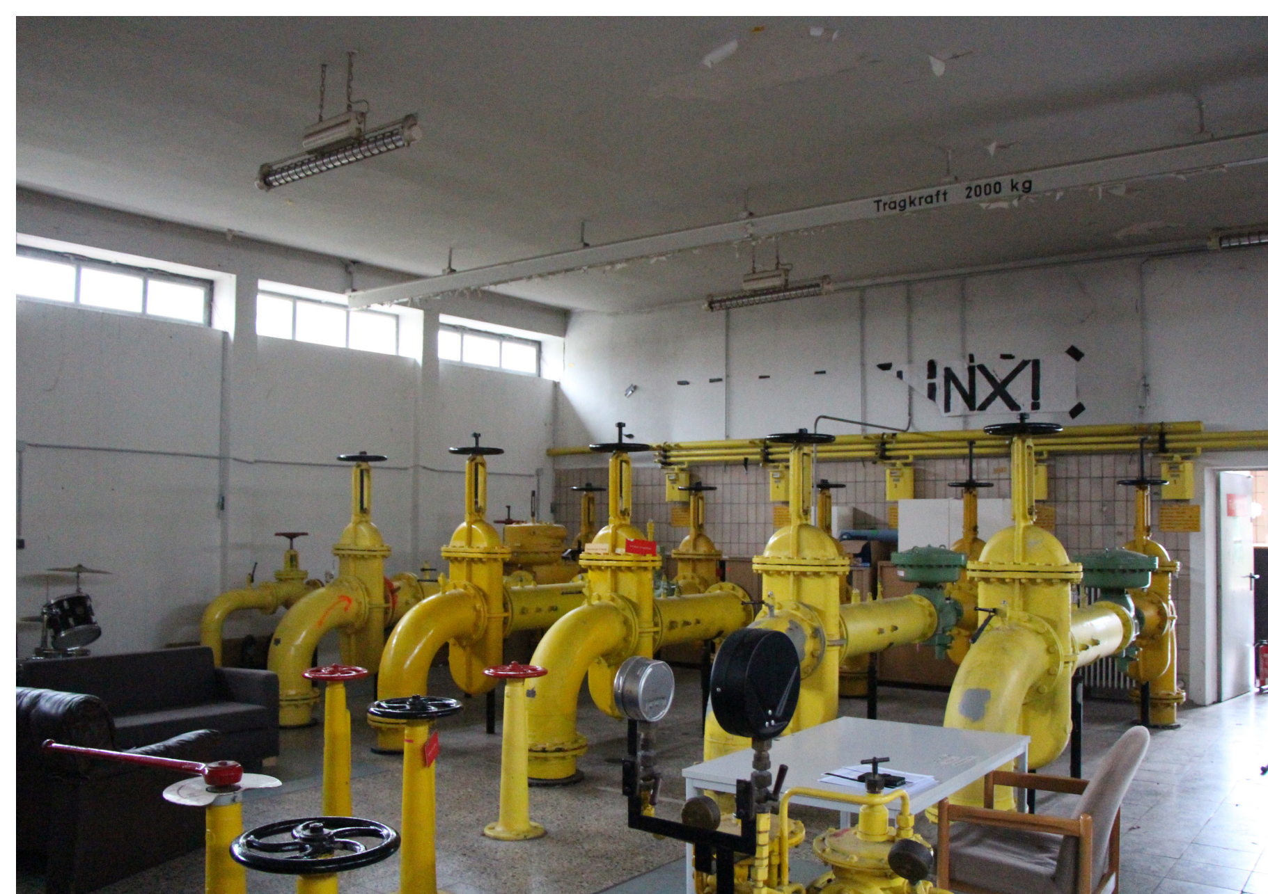
Erhaltene Gasdruckregler in der Gasreglerstation (der letzte an der Außenwand ist denkmalgeschützt) Foto: ©Büro Luchterhandt
