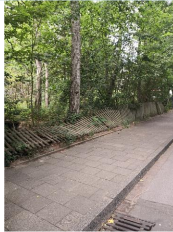
Entfernung defekter Jägerzaun Eichendorffstraße
