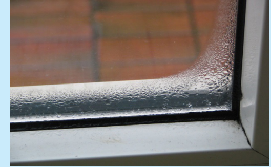
يتعين مسح المياه لنلا يلزم طرد هذه الرطوبة عبر هواء الغرفة.
